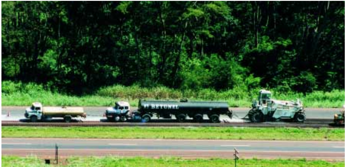
La recicladora WR 2500 de Wirtgen impresiona por su eficacia en el reciclaje en frío con betún espumado en una obra de construcción de una autopista en Brasil.
