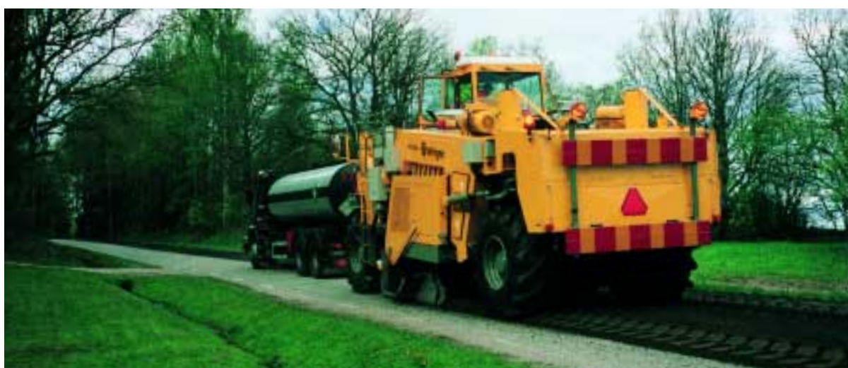
Saneamiento ecológico de carreteras en Suecia empleando betún espumado: el tren de reciclaje con la máquina WR 2500 es garante de un procesamiento rápido de las vías de tráfico dañadas.
