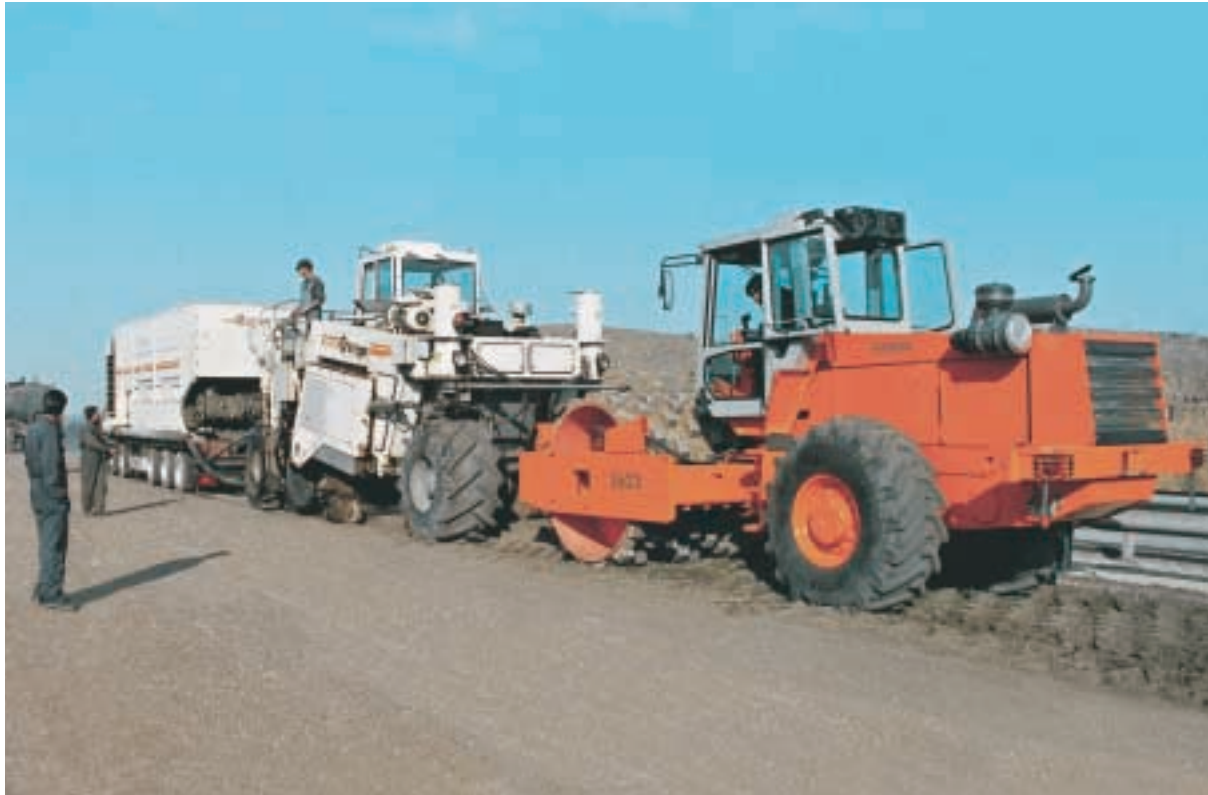
Reciclaje en frío con betún espumado ejemplar: durante los trabajos en el Teheran-Qom Highway, se manifestó con especial claridad la eficacia de la máquina WR 2500 de Wirtgen.
