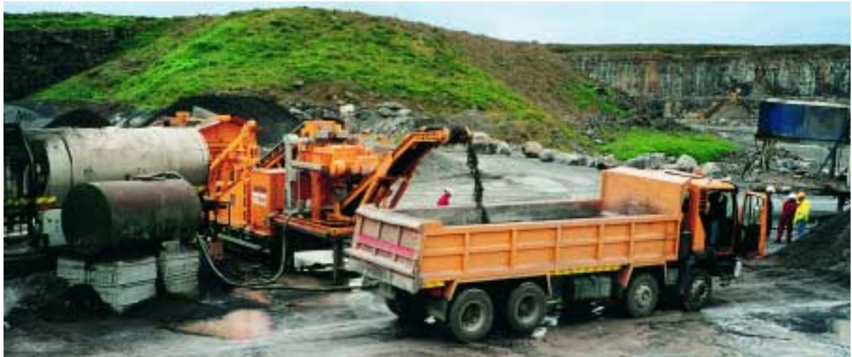
Correspondiendo a las exigencias de la medida de construcción, en esta cantera en Irlanda se está produciendo mezcla en frío de fracciones de roca, por ejemplo, añadiendo betún espumado.
